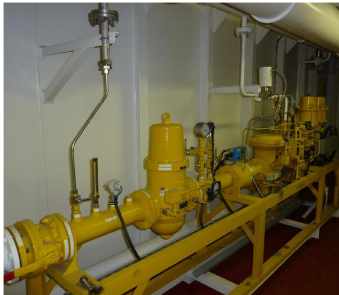
Figura 27 - Tubulação e regulador da pressão de gás.
